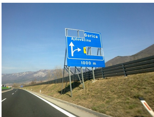
1.2 Uničena prometna signalizacija
